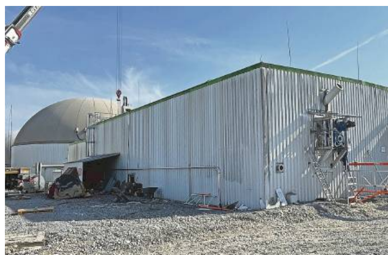
Die Biomethan-Anlage im Gewerbegebiet „Waldäcker“ erhält neue Annahmehäuser für Stroh, Mist und Mais. Auch der Gärbehälter (rechts) wird restauriert.
