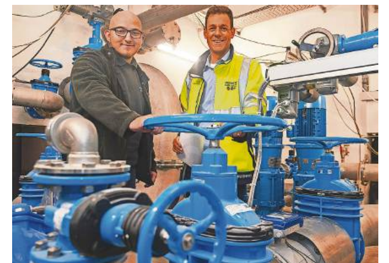
Marcel Kopf (links) und Frederik Trockel stellen die erneuerte Technik im Wasserhochbehälter Lindach in Mühlacker vor.
